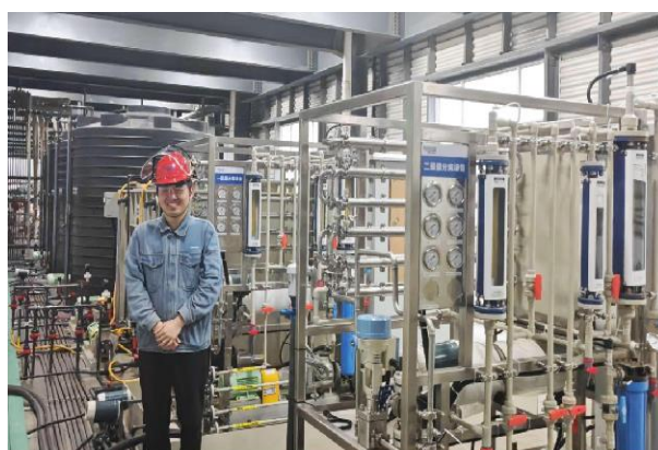
广西钦州某镍离子价值回收项目
